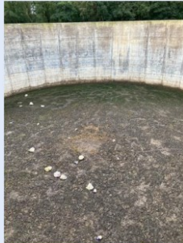
Foto 8: Bovenaanzicht van de mestilo. De bruine laag is de moeilijk verpompbare mest met daar bovenop plastic zakken met afval.
